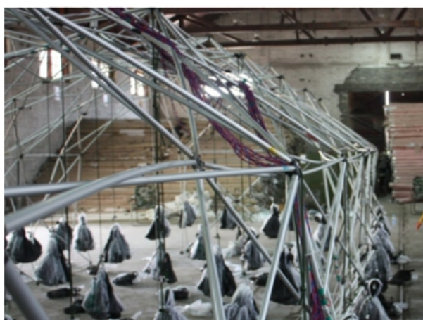
图 8 爬坡单元下边杆变形图
