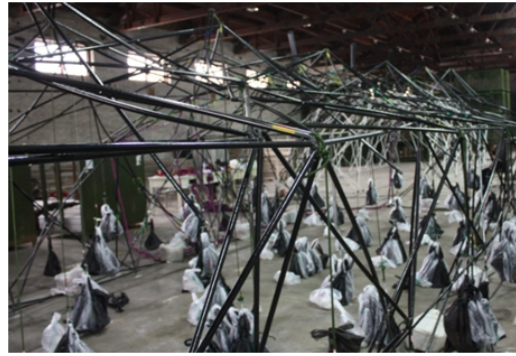
图7 玻璃纤维网壳结构整体破坏图
